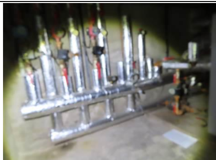
Photo n° PhA008 Localisation : S-Sol - Chaufferie Ouvrage : 1. Flocages, Calorifugeages, Faux plafonds Partie d'ouvrage : Calorifugeages Description : Calorifugeages (coquilles laine de roche-aluminium)
