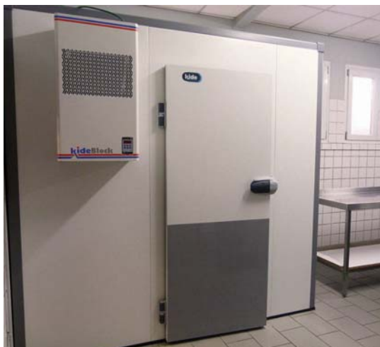
Nouvelle Chambre froide salle des spectacles
